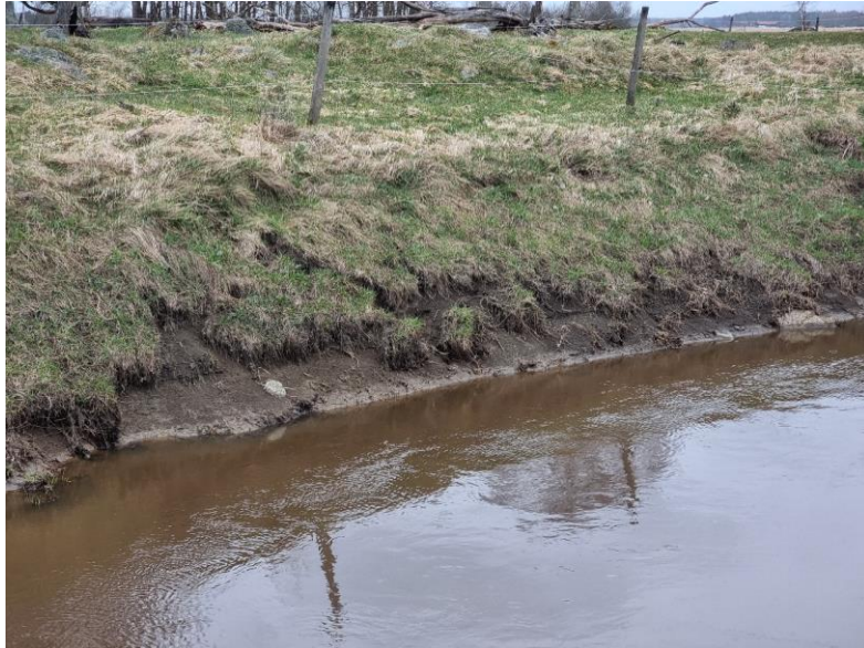
Figur 9. Sträckan har stora problem med erosion.
